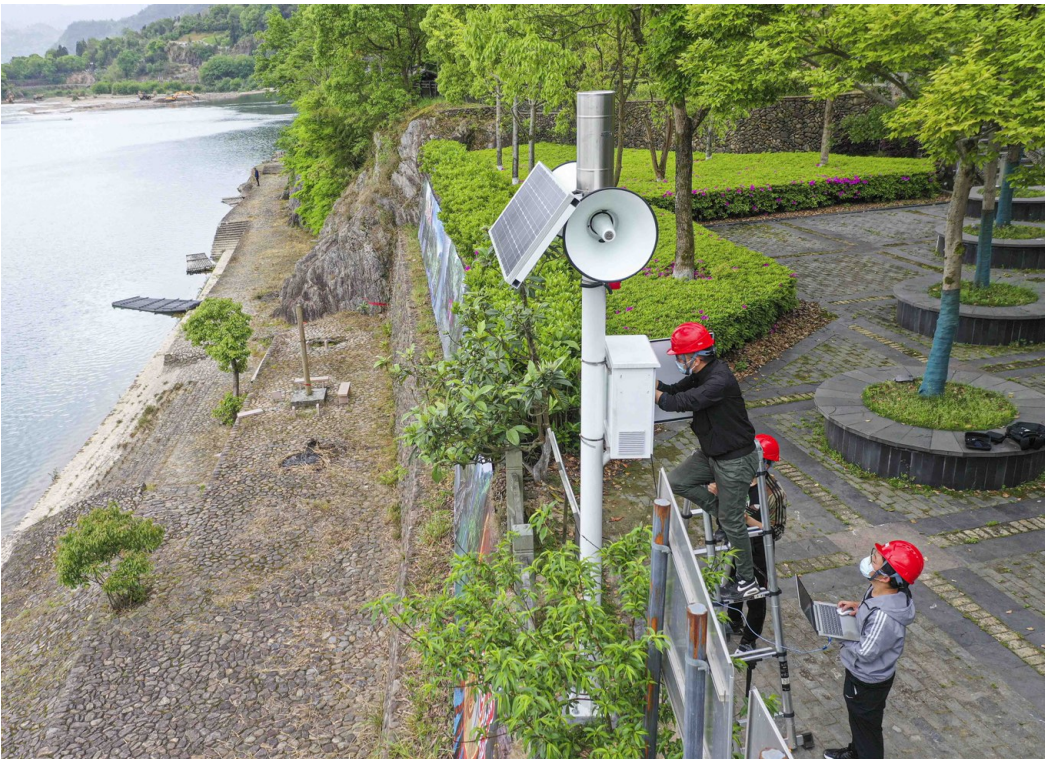
4月15日,全省入汛。我省气象部门在永嘉、乐清等山洪灾害高危地区安装了63套山洪灾害声光电预警设备,实时监测水位和雨量等信息。这些预警设备将以最直接显眼的警报灯、警鸣以及播报预警信息通知周围群众,为人员避险争取宝贵时间。图为气象工作人员在永嘉县大元下村调试设备。 苏巧将 摄
