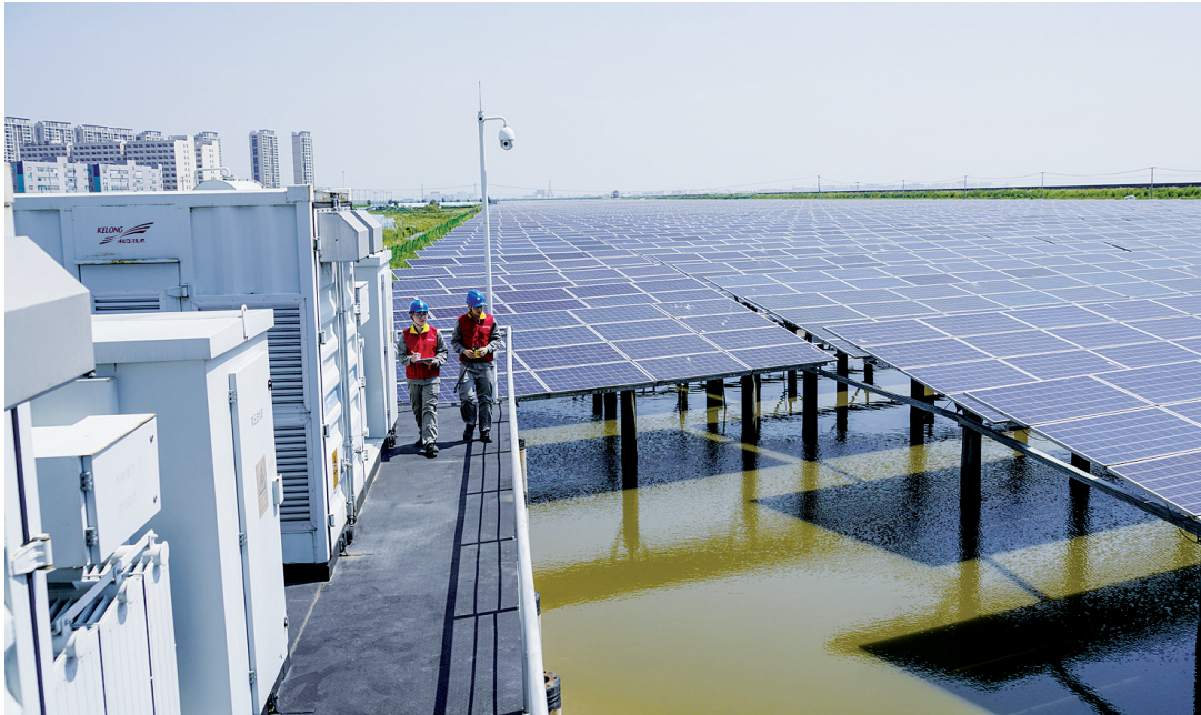
为备战夏季用电高峰,近日,电力工人在温州市瑞安阁巷产业聚集区40MW“渔光互补”光伏电站巡检设备。据悉,该光伏电站年可发电4000多万千瓦时,可满足周边地区1.5万户左右居民日常用电。
